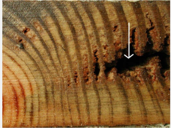
Befallsbild mit Innenfäule
