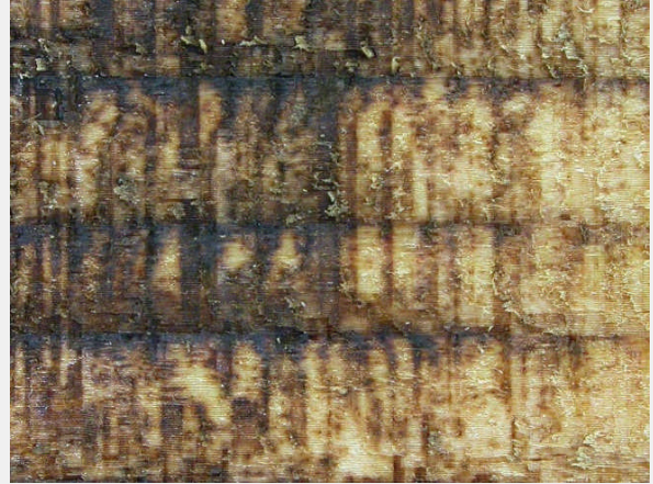
Befallsmerkmale am Holz
